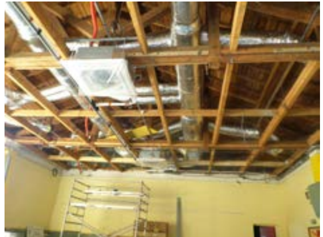
Réseau de gaines en faux-plafond pour assurer le chauffage, le renouvellement d'air et la climatisation.
