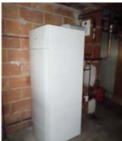
Une nouvelle chaudière économe en énergie
